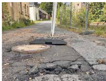
Ein verschraubter Kanaldeckel wurde mitsamt der Asphalt-Einfassung herausgerissen. Fotos: Gemeindeverwaltung
